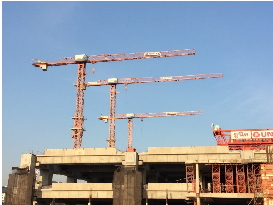
ค. ปั่นจั่นหอสูง (Tower Crane)
