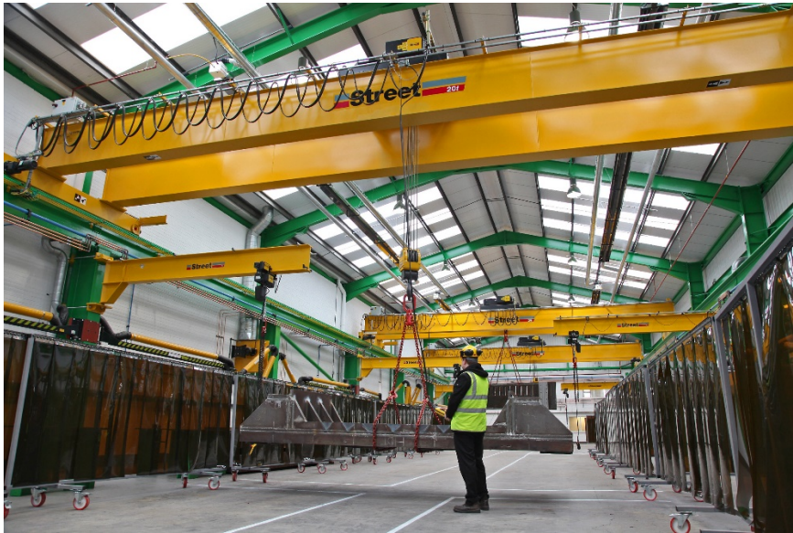
ก. ปั่นจั่นเขาสูงศีรษะ (Overhead Crane)
