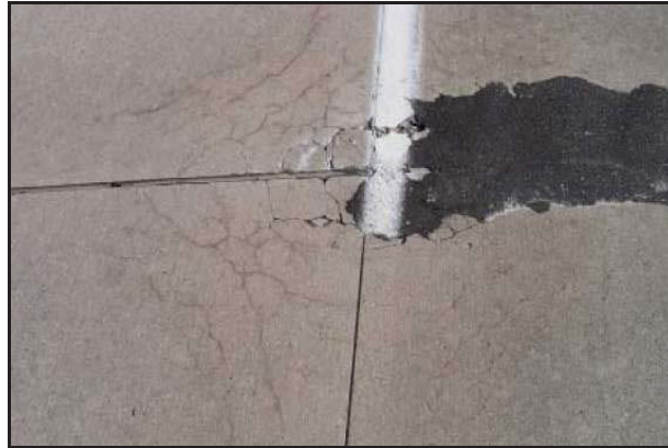
รูปรอยแตกจากคอนกรีตสูญเสียความทนทาน
