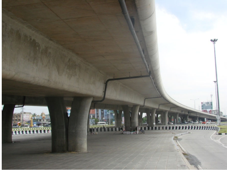
รูปที่ 1.24 ท่อ HDPE เพื่อใช้สำหรับระบบระบายน้ำจากบนสะพานในสะพานประเภท Box Girders
