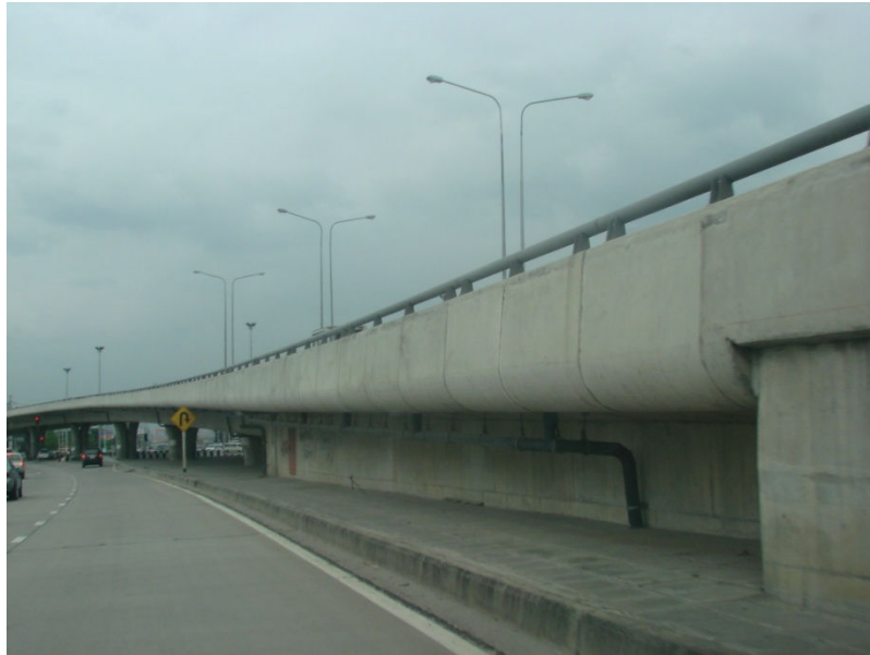
รูปที่ 1.22 ท่อ HDPE เพื่อใช้สำหรับระบบระบายน้ำจากบนสะพานในสะพานประเภท Box Girders
