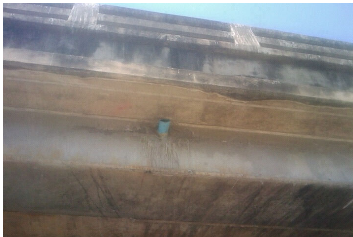
รูปที่ 1.14 แสดงท่อ PVC ในสะพานประเภท Box Beam
