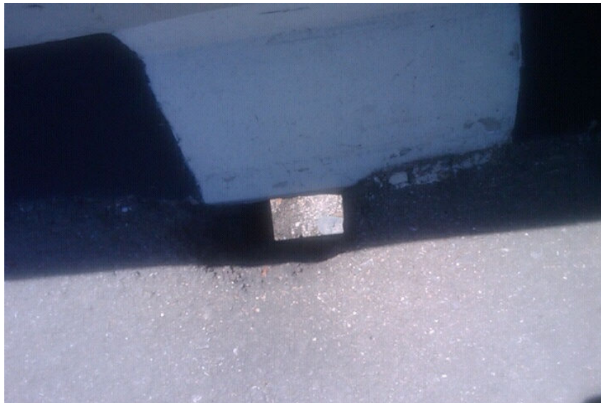
รูปที่ 1.5 แสดง Mortar Pipe ในสะพานประเภท Slab Type
