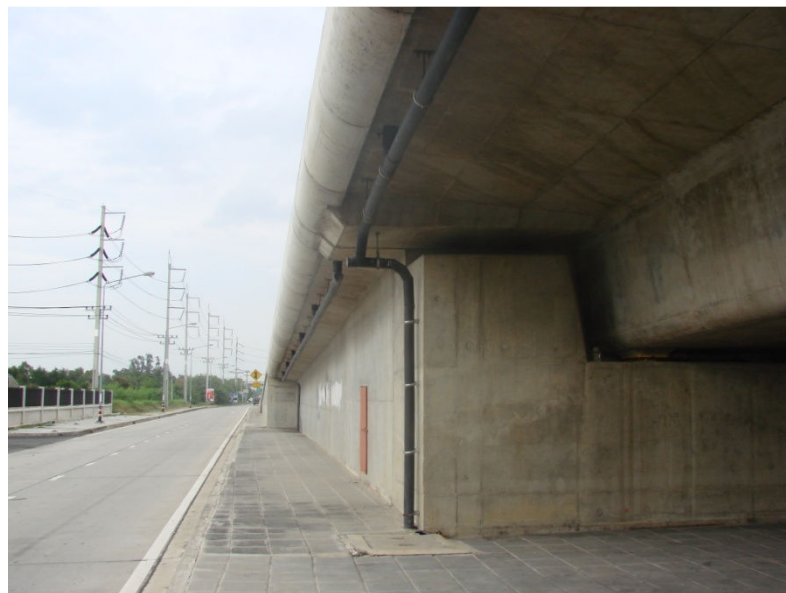
รูปที่ 1.23 ท่อ HDPE เพื่อใช้สำหรับระบบระบายน้ำจากบนสะพานในสะพานประเภท Box Girders
