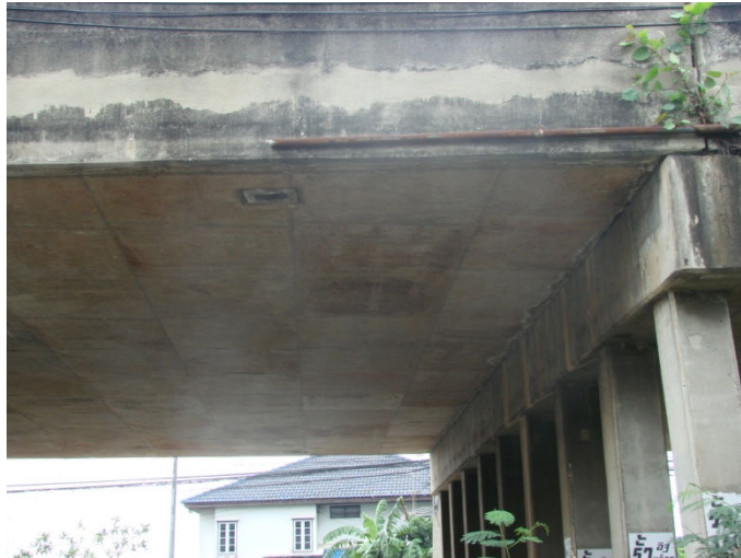
รูปที่ 1.6 แสดง Mortar Pipe ในสะพานประเภท Slab Type
