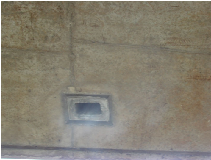
รูปที่ 1.7 แสดง Mortar Pipe ในสะพานประเภท Slab Type
