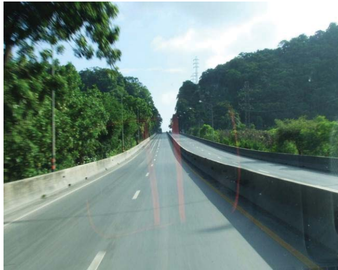
รูปที่ 26 ราวกันของเกาะกลางแบบ Concrete Barrier
