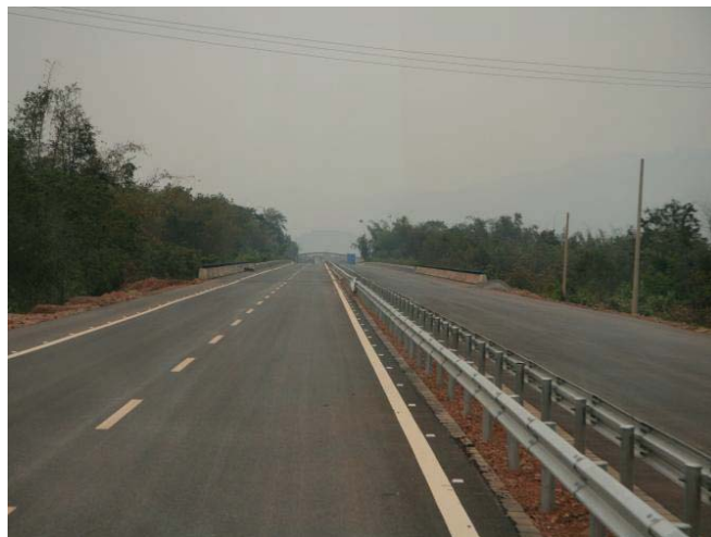
รูปที่ 20 ราวกันของเกาะกลางแบบแผ่นเหล็ก Steel Beam Guard Rail (W-Beam)
