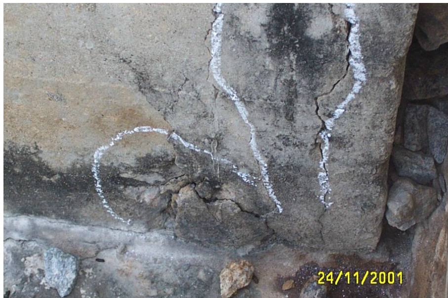
รูปที่ 3-7 Cracks
