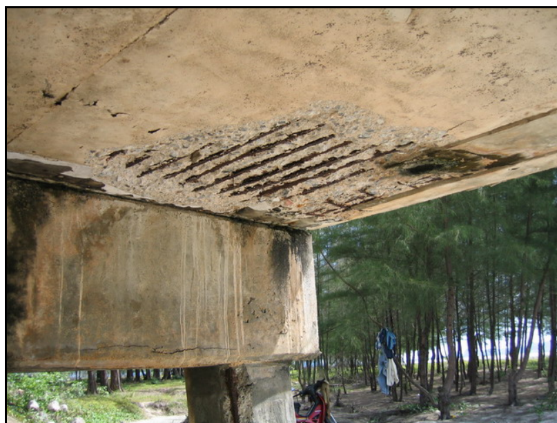
รูปที่ 3-9 Delamination and Spall
