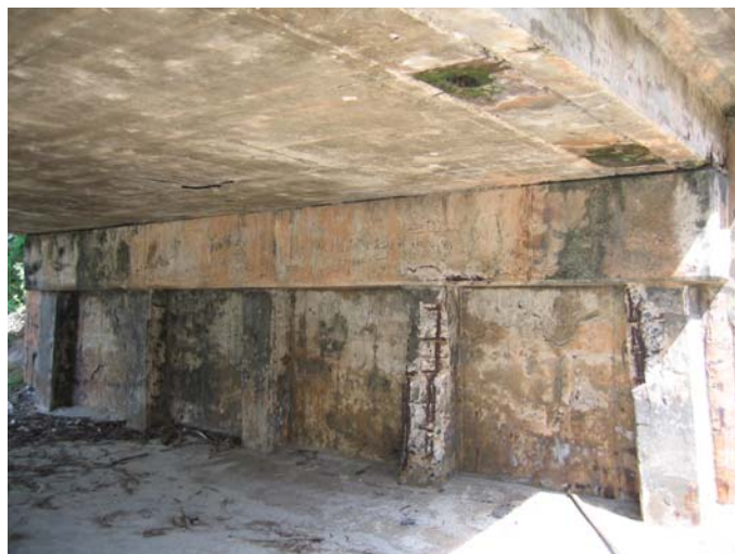
รูปที่ 6-33 การเสื่อมสภาพของกำแพงตอม่อริมฝั่งคอนกรีต
