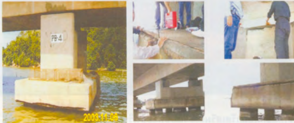
รูปที่ 1 ความเสียหายของตอม่อสะพานติณสูลานนท์ (สะพานเดิม)
