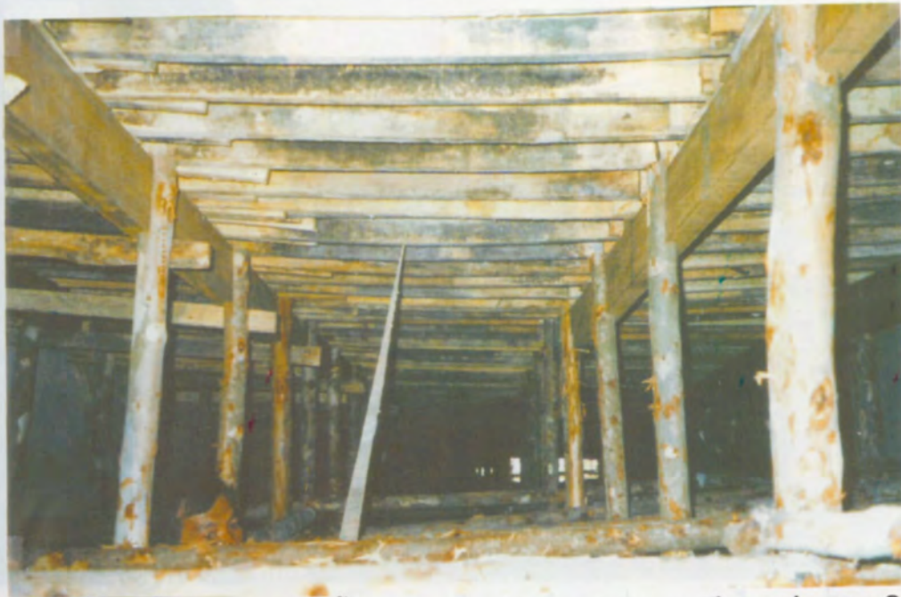
รูปที่ 18 แสดงค้ำยันและตงรับพื้นบน Bridge Approach Structure มีระยะห่างมากเกินไป เกิดการแอ่นตัวขณะเทคอนกรีต
