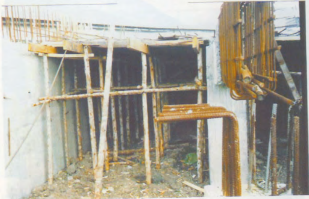
รูปที่ 20 ค้ำยันและนั่งร้านที่อยู่บนพื้นรองรับซึ่งไม่มีความแข็งแรงเพียงพอ
