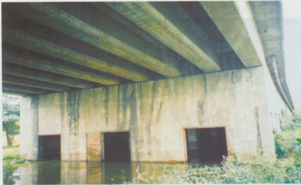
รูปที่ 15 ปัญหา น้ำท่วมขังภายใน Bridge Approach Structure
