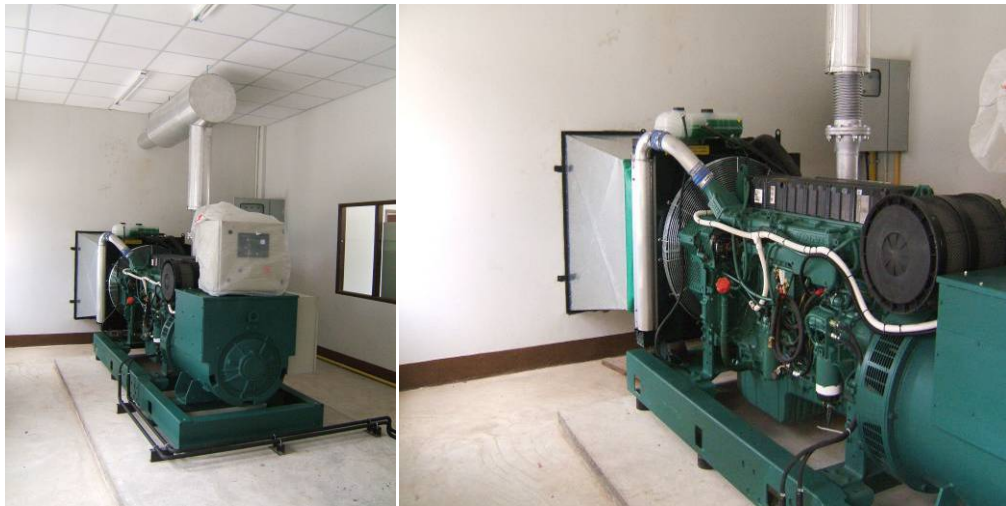
รูปที่ 6-7 เครื่องกำเนิดไฟฟ้า (Generator) ภายในอาคารควบคุม
