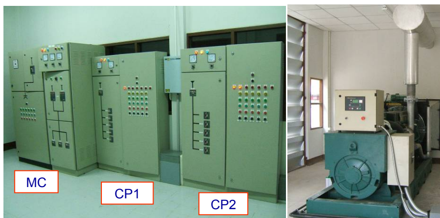
รูปที่ 6-8 ส่วนควบคุมระบบ Pump และ ส่วนควบคุมเครื่อง Generator
