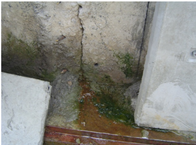
รูปที่ 3-37 ตัวอย่างการรั่วซึมบริเวณรอยต่อแผงคอนกรีตผนังปิด
