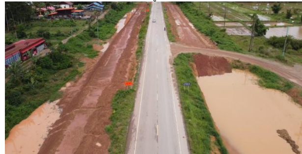
ง. งานตรวจสอบตำแหน่งการติดตั้งป้ายจราจรและทางเชื่อม
